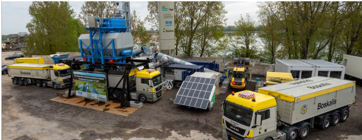
Figuur 13. De Helice: een CO 2 -neutrale, elektrische en mobiele asfaltcentrale. Ingezet voor de productie van een klein deel van het toegepaste asfalt.
