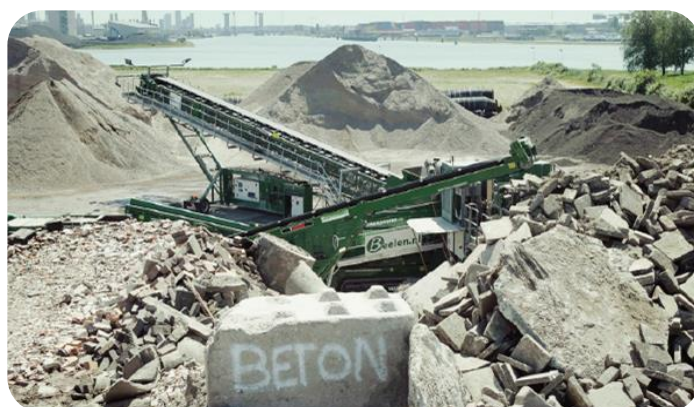
Figuur 4-2 Breekinstallatie Beelen
